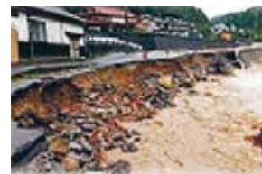
〈被災した道路〉
