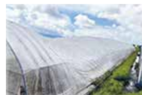
〈被災したイチゴハウス〉
